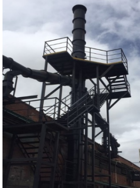
FOTOGRAFIA 6. DUCTO DE DESCARGA DEL PROCESO DE PINTURA ELECTROSTATICA (APLICACIÓN Y SECADO, HORNO DE ARCO ELECTRICO)
