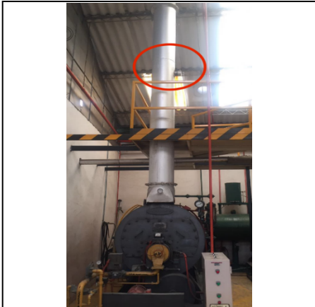
FOTOGRAFIA 2. CALDERAS DE 75 BHP
