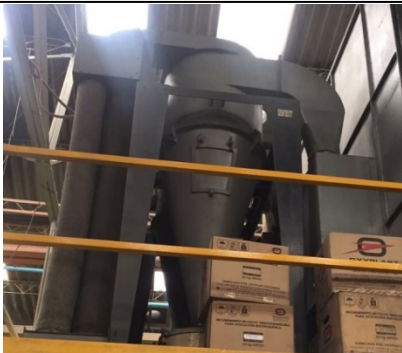
FOTOGRAFIA 8. SISTEMAS DE CONTROL DE PROCESO DE PINTURA ELECTROSTATICA
