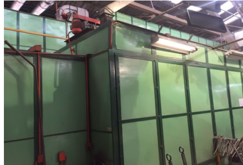
FOTOGRAFIA 7. CABINA DE PINTURA ELECTROSTATICA
